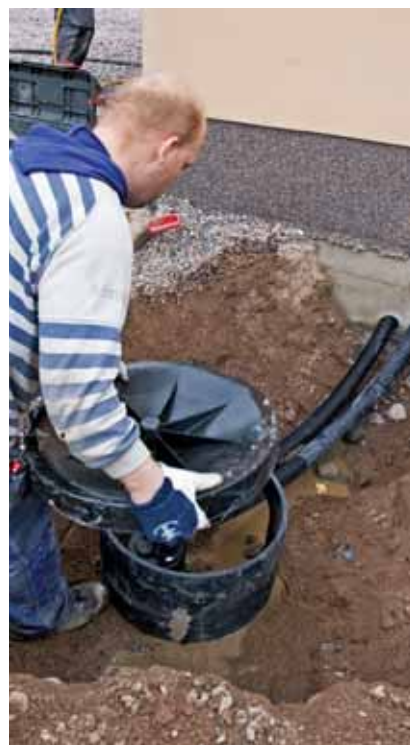
Huoltokaivo voidaan peittää ja jättää näkymättömiin maan alle.
